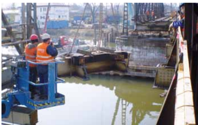
NAD VODOU. Více než stoletý železniční most musí stavbaři rozebrat po částech za pomoci těžké techniky.
