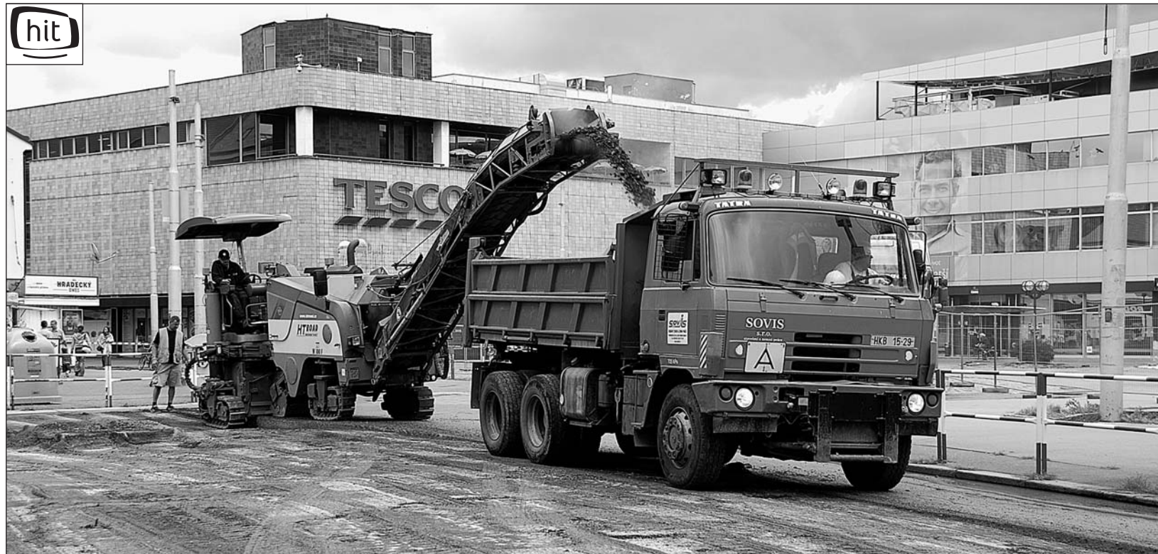
Dlouho očekávaná rekonstrukce náměstí 28. října a přilehlých ulic S. K. Neumanna a Dukelská začala. Práce, jejichž cílem je zlepšit stav této frekventované části města, mají trvat do podzimu příštího roku, přičemž nejdříve přijde na řadu obnova výše zmíněných ulic a průjezd náměstím, až poté vlastní plocha náměstí. Foto: Martin ČERNÝ
